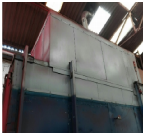
FOTOGRAFÍA 2: HORNO DE ACTIVACIÓN DE PINTURA Y DUCTO
